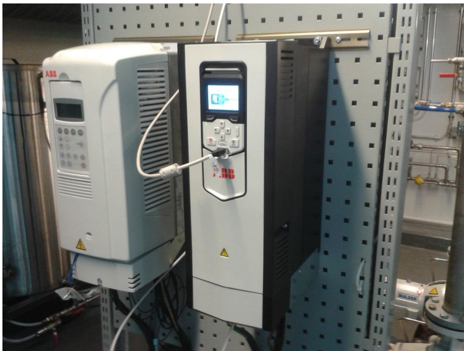
Kuva 3.1 Työssä kohdelaitteena käytetty ACS880 taajuusmuuttaja, jolla ohjataan pumppua
