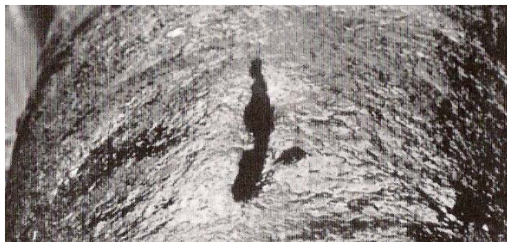
Kuva 5. Putken korroosio ulkopinnalta kuvattuna [24].
