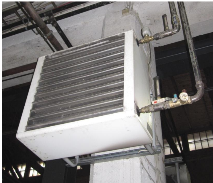
Kuva 6. SEW Industrial Gears Oy:n tehdashallin kiertoilmalämpöpuhallin.
