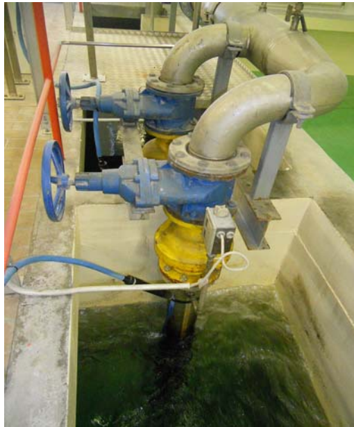
Kuva 15. Huhtiniemen Grundfosin uppopumput.
