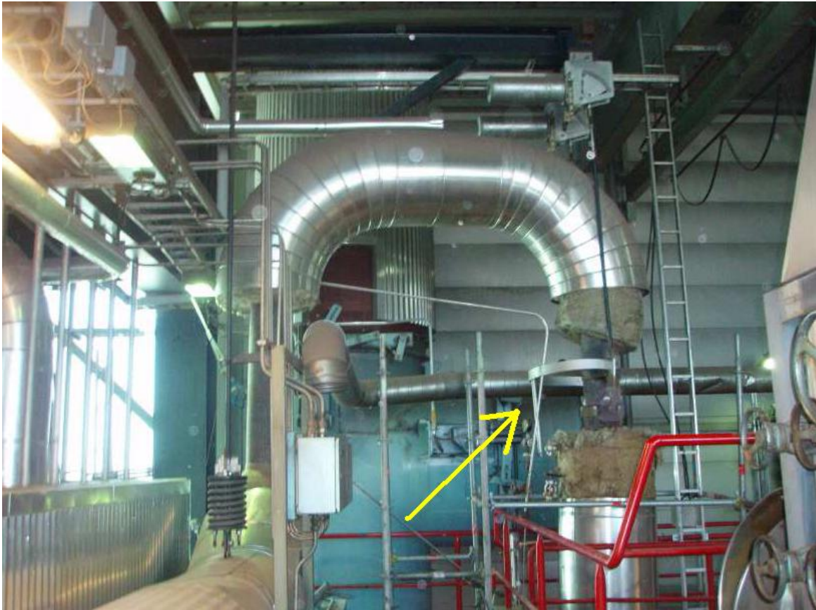
Kuva 14. Päähöyryputken vaurioitunut kannake. (Inspecta Oy. Nikkarila, R. 2009)
