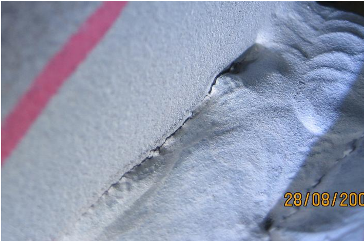
Kuva 13. Savukaasupuhaltimen siiven säröytynyt hitsi. (Uljanoff, R. 2007)
