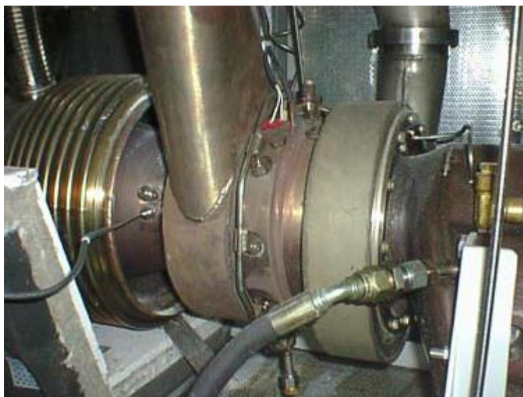
Kuva 14. Talbott's Heatingin mikroturbiini. Kompressorin ja turbiinin kotelointia muutettu maakaasukäyttöön nähden. (Pritchard 2002)
