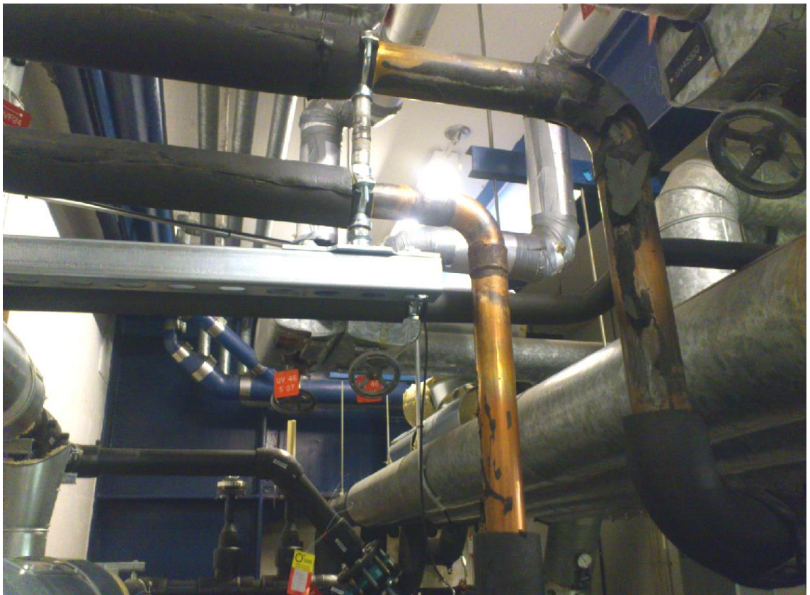
Kuva 1. Lämmönvaihtimen kupariputkia Loviisan ydinvoimalaitoksella.
