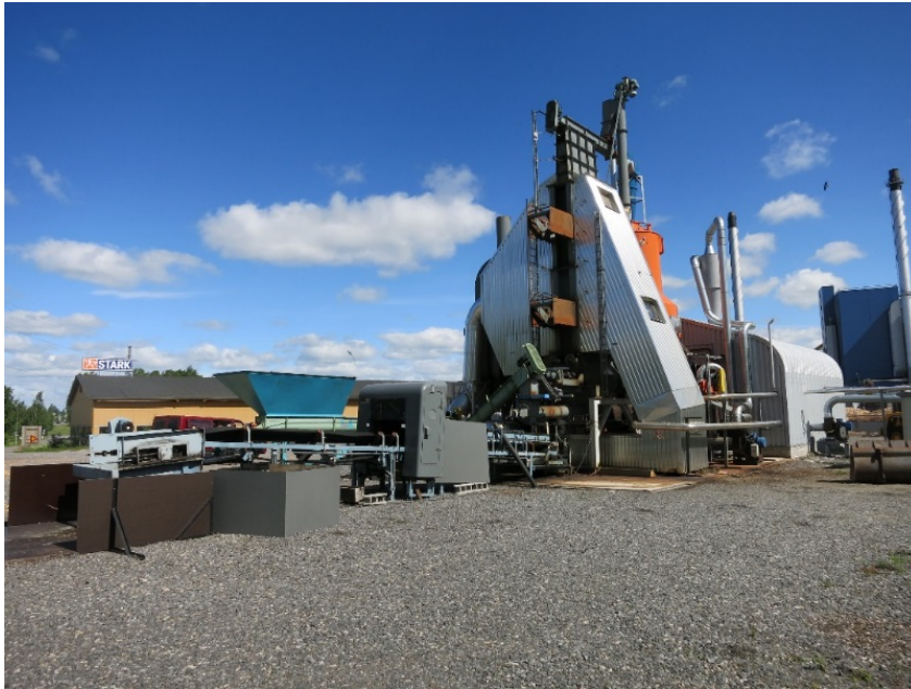
Kuva 16 Pilottilaitos sijaitti Etelä-Savon Energian Pursialan voimalaitoksen yhteydessä Mikkelissä.
