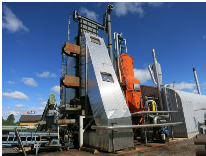
Kuva 5 Torrec Oy:n pilottitehdas Mikkelissä.
