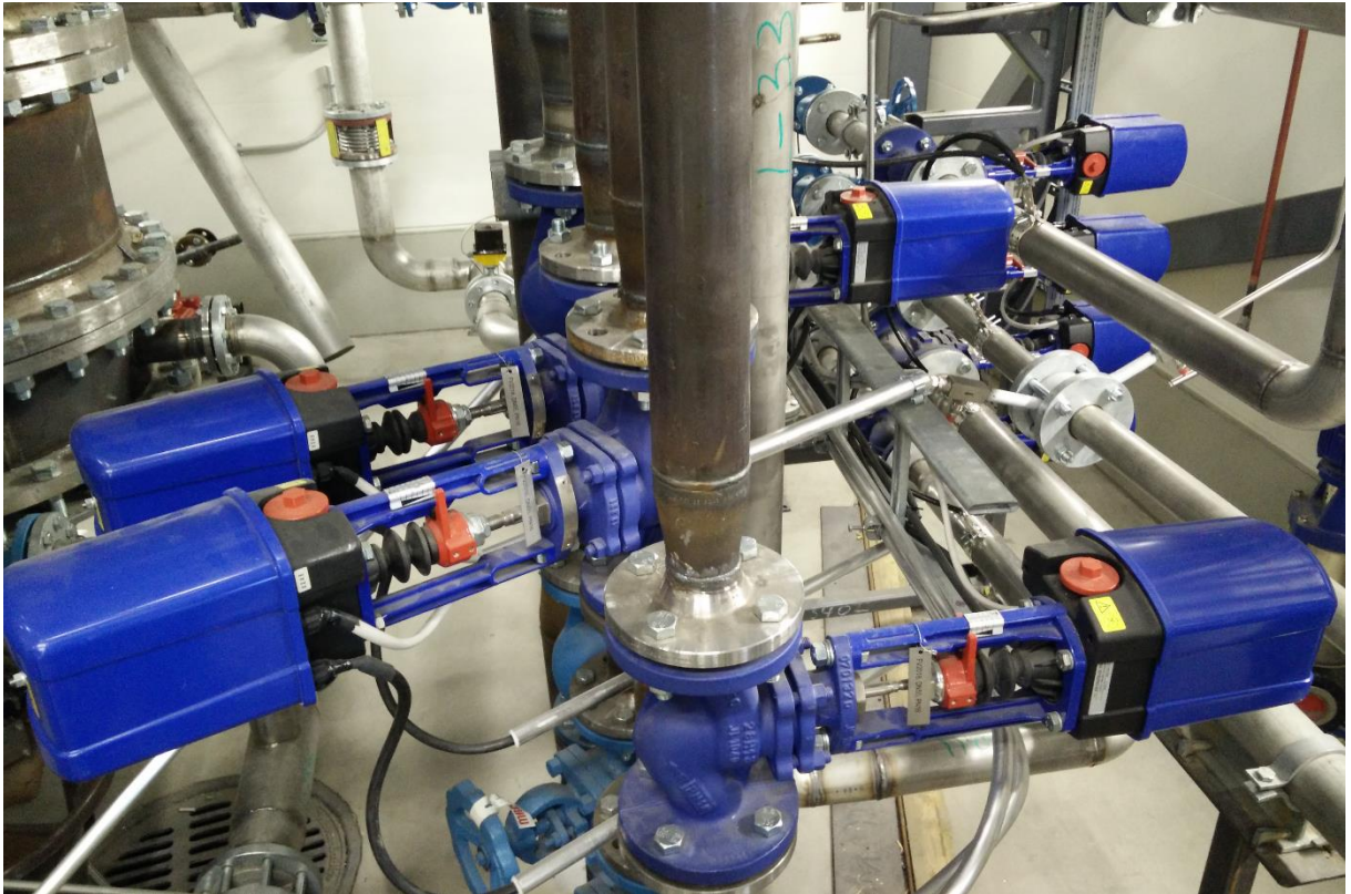
Kuva 3.5. Palamisilman sekundääri-ilmatasojen säätöventtiilit.
