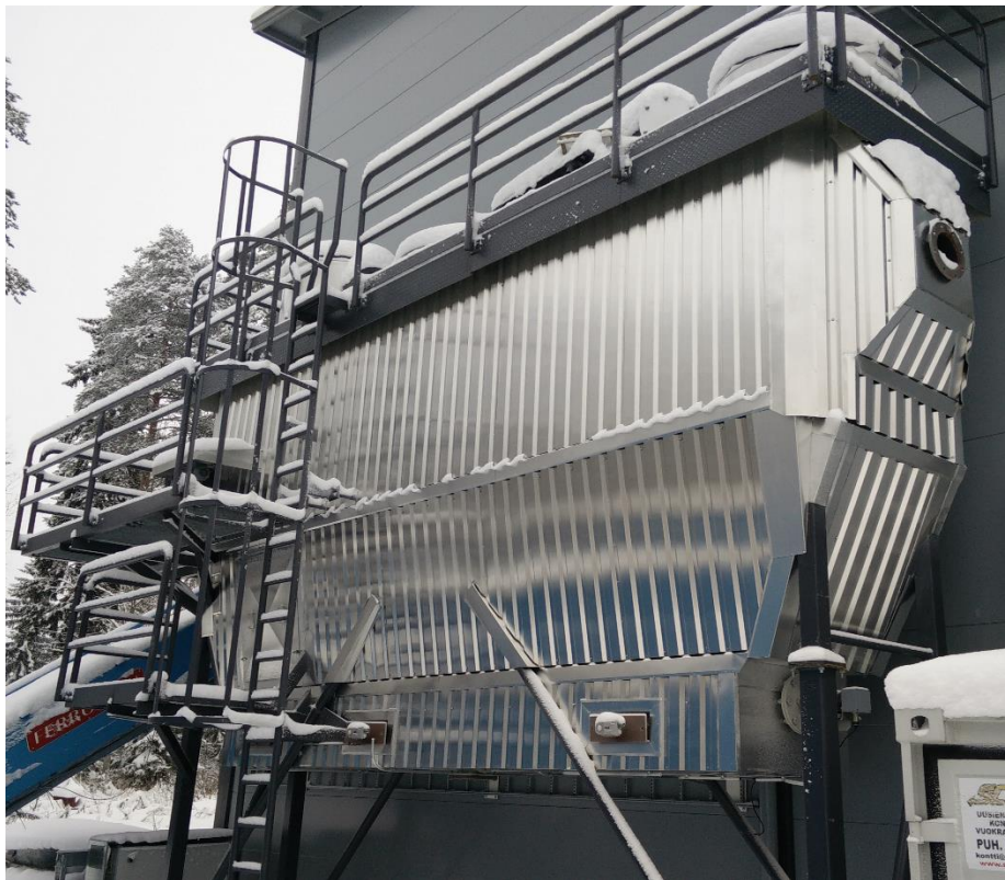
Kuva 3.4. Sähkösuodatin odottamassa kytkentää.
