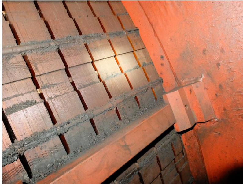
Kuva 26. Levypaketin päälle muodostunutta likaa.
