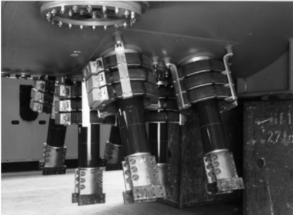
Kuva 12. Generaattorin läpiviennit. (Klempner 2004 s.64)
