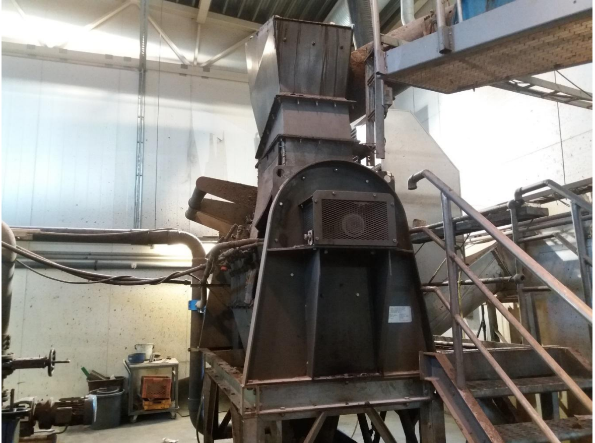
Kuva 4. Separattori, joka erottelee pakkausmateriaalit mädätettävästä aineesta.
