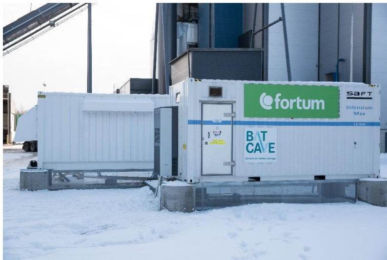
Kuva 13 Fortumin Batcave-akkukontti projekti. (Fortum, 2017a)
