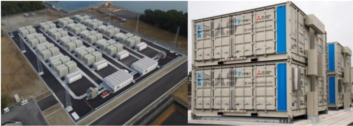
Kuva 15 Kyushu electric Powerin Buzen aseman ilmakuva vasemmalla. Oikealla kuva kahdesta akkukontista sijoitettuna päällekkäin. (Mitsubishi Electric, 2016)
