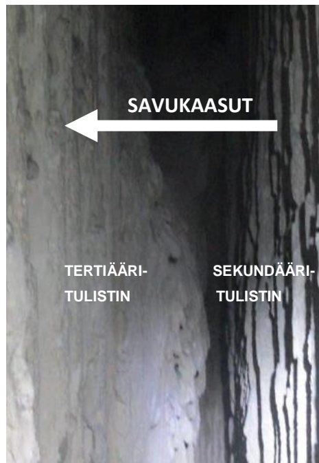
Kuva 51. Savukaasukanavan runsasta likaantumista sekundääri- ja tertiäritulistimen välisellä alueella (Kimmo Pakkanen)
