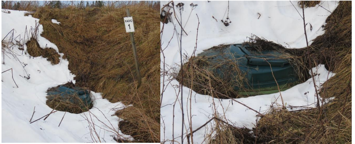
Kuva 14. Seutulän kaatopaikan kaasunkeräyskaivo.
