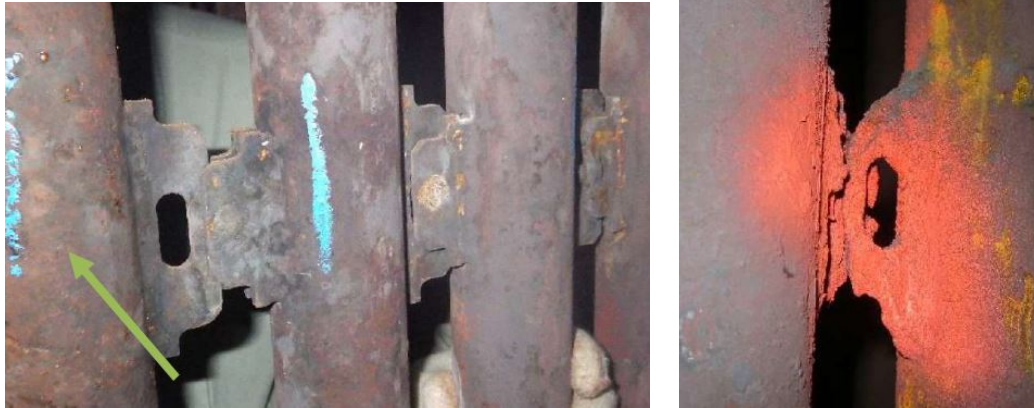
Kuva 13. Siteiden korroosiovaurioita, jolloin tulistinputket pääsevät liikkumaan. (Mäkelä 2018, s. 22; Tarkastusraportti RB3 2016, s. 27)
