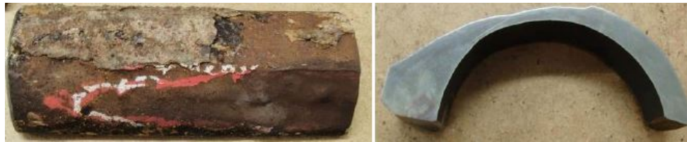
Kuva 7. Leijupetikattilan seinähöyrystinputki kattilan nokan vierestä, joka on nuohoimen puhalluksen seurauksena kärsinyt eroosiosta. (Nafari 2018, s. 3)
