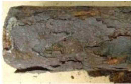
Kuva 6. Tulistinputken sulfidoituminen oksidikerroksen sijaan. (Nafari 2018, s. 5)
