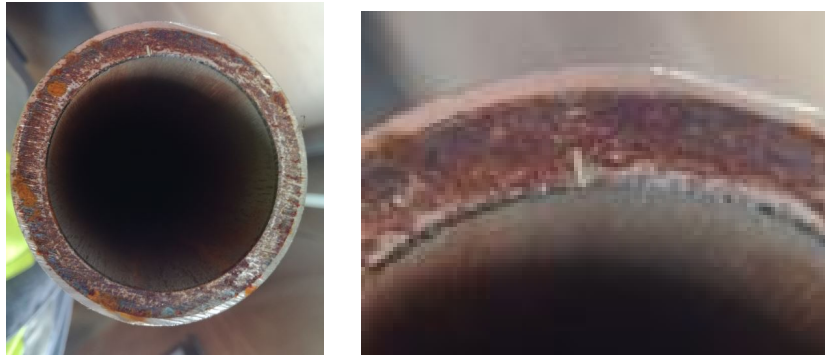
Kuva 15. Sanicro 38 putki, missä on havaittavissa seostamaton teräs sisällä ja seostettu teräspinnoite.
