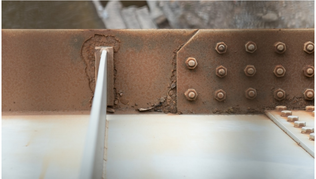
Kuva 18. Teräspalkin alalaipan korroosioaurio (Kaira Tuomas k, 27.4.2019)
