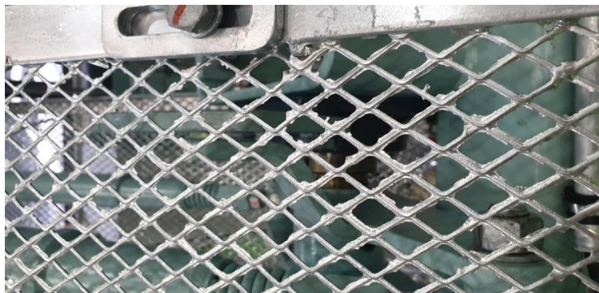
Kuva 42. Kuumasinkityksestä aiheutuneet valumat teräsverkossa.
