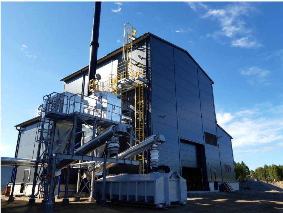
Kuva 25. Valmistunut Rovaniemen laitos Alakorkalon jätevedenpuhdistamolla (NEVE 2019).
