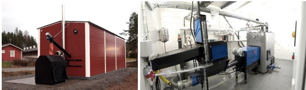
Kuvat 6 ja 7 Vasemmalla siirrettävä lämpökontti kattilatehon kokoluokassa 60–150 kW ja oikealla kattilahuone kattilateholla 120 kW (Biofire Oy)
