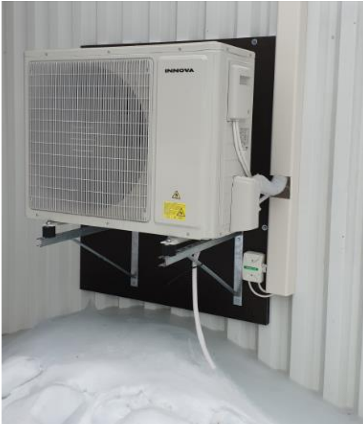
Kuva 24. Ilmalämpöpumpun ulkoyksikkö (7,5 kW) myymälän seinällä. Valmistaja Innova.
