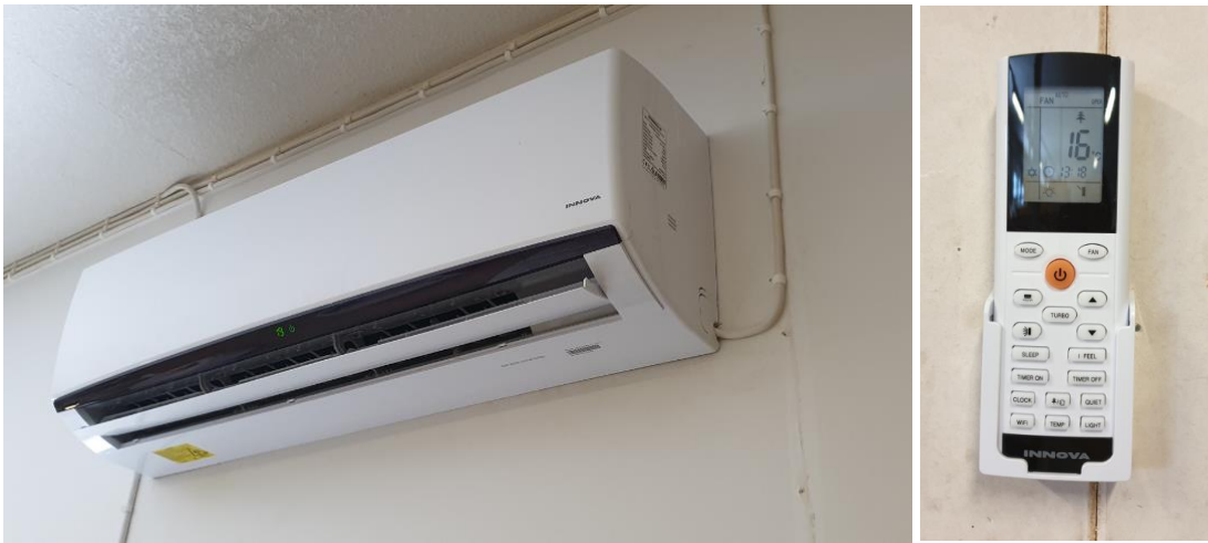
Kuva 23. Ilmalämpöpumpun sisäyksikkö (7,5 kW) ja säädin myymälässä. Valmistaja Innova.
