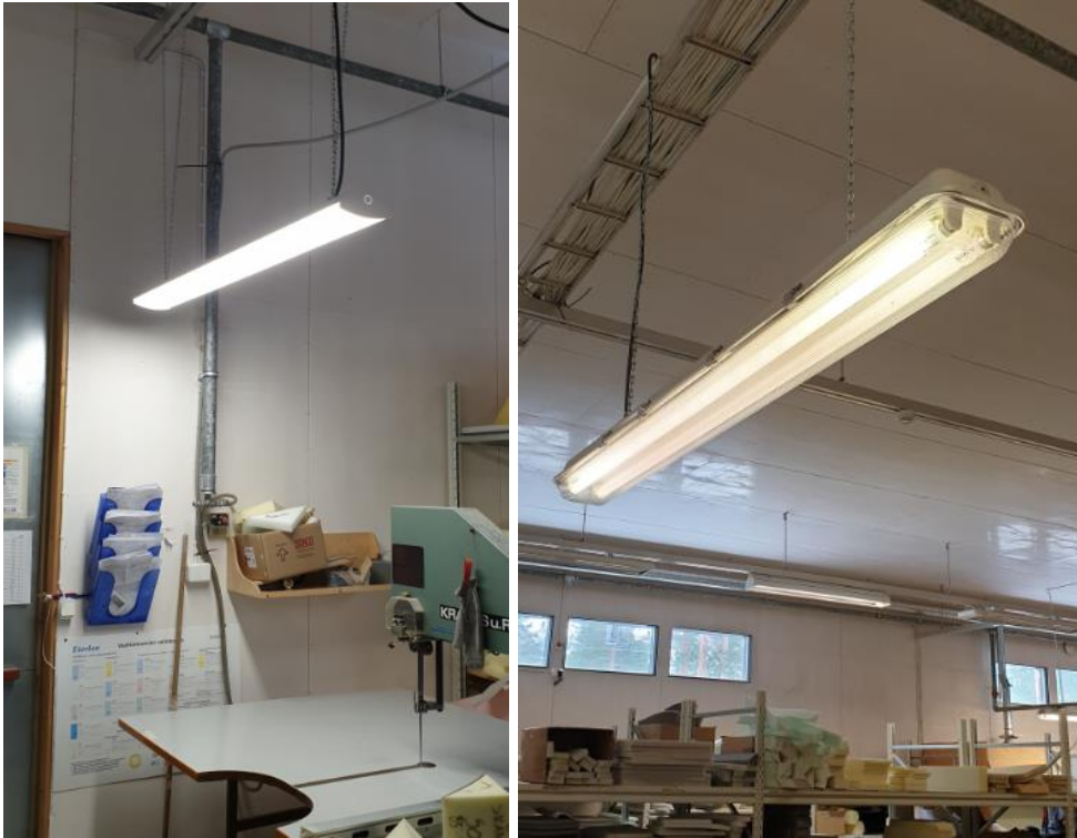
Kuva 28. Tehtaan työpisteiden valaistus. Vasemmalla kuvassa vaihdettu uusi led -valo ja oikealla vanha halogeenivalaisin. Tehokkaampi valaistus parantaa myös työtehokkuutta.
