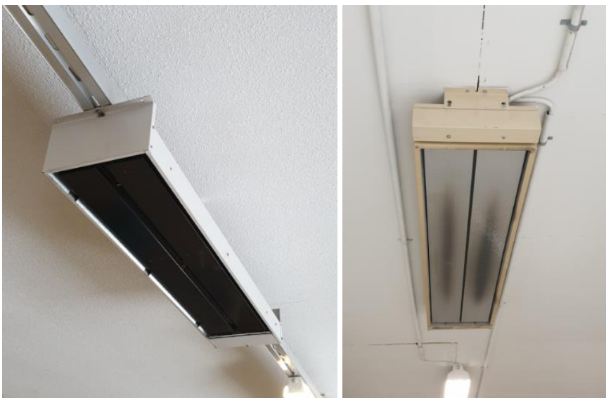
Kuva 21. Tehtaan sähköisiä säteilylämmittimiä.
