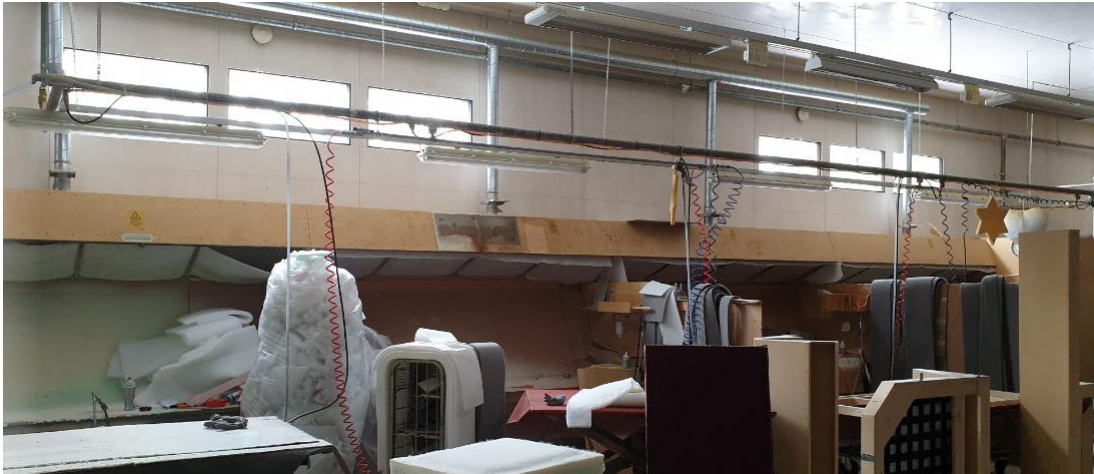
Kuva 26. Liimaamon poistoilmahuuvut ja kanavointia.
