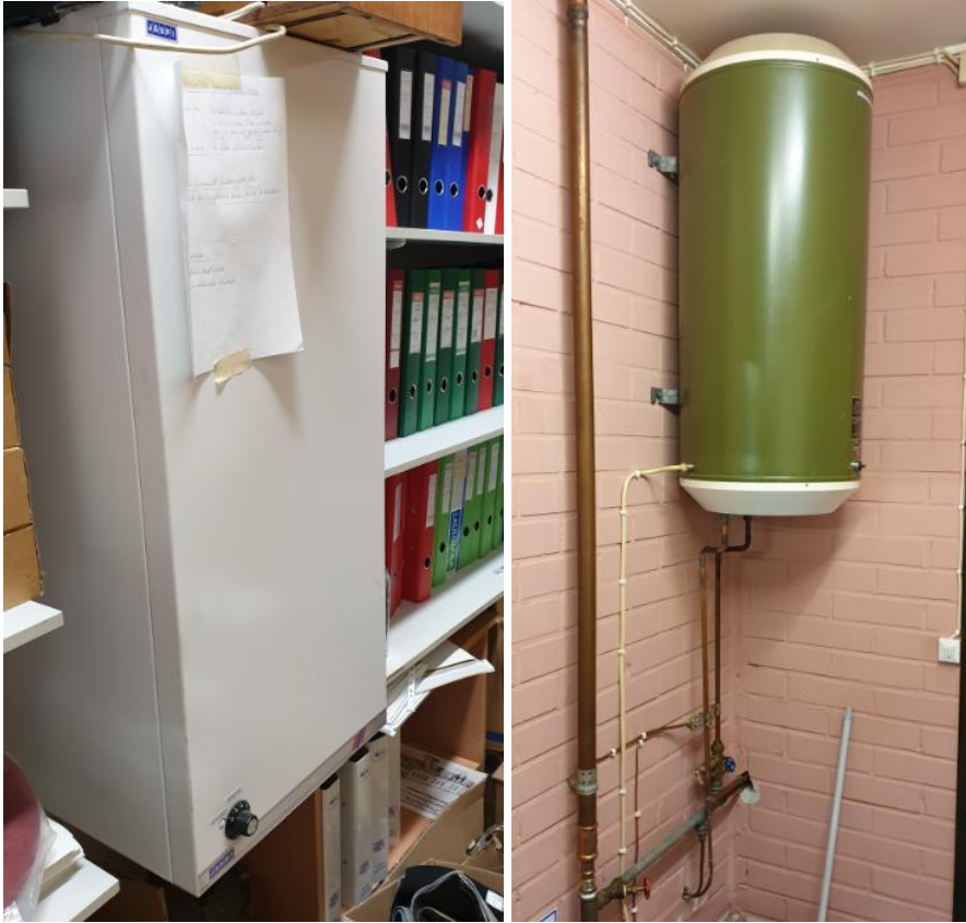
Kuva 25. Lämpimän käyttöveden varaajia tehtaalla.
