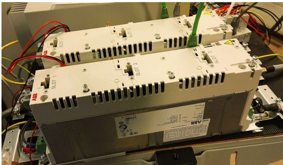
Kuva 3.9 Testilaitteistossa olevat ABB:n ACSM1-04AS-07A0-4 taajuusmuuttajat. Yksi taajuusmuuttaja antaa virtaa yhdelle sähkömagneettiparille.
