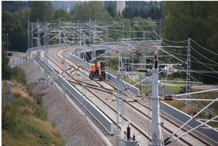
Fig. 1. Low-height noise barrier in Finland (Liikennevirasto, 2017).
