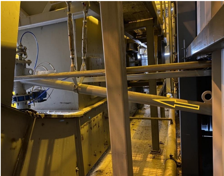
Kuva 7. Syöttöruuvi kuljettaa rikkipastillit polttoainekuljettimen päälle. (Nevel, 2022)
