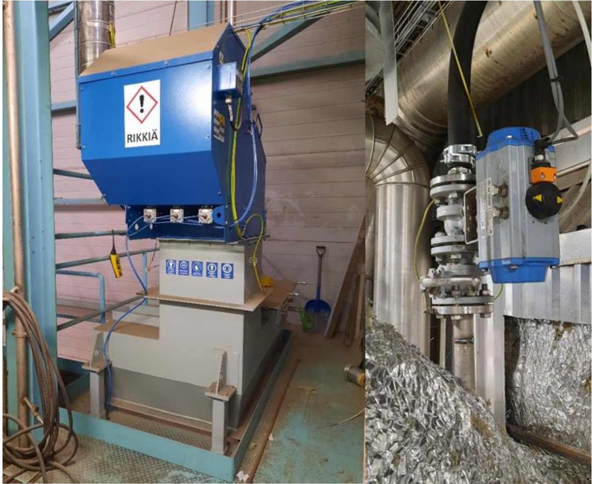
Kuva 11. Rikin siirtopuhallin ja syöttöyhde tulitorveen. Kuvat otettu revisioaikana. (Nevel, 2022)
