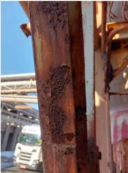
Kuva 6. Paikallista pistekorroosiota jäykisteen alapinnalla
