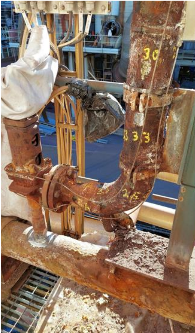
Kuva 9. Eristeen alainen korroosio varoventtiilin ulospuhallusputkessa
