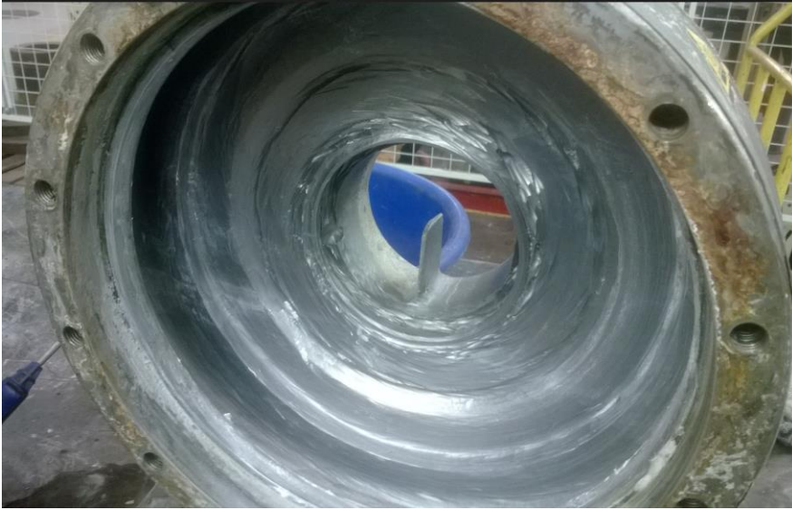
Kuva 10. Eroosion kuluttama pumpun pesä
