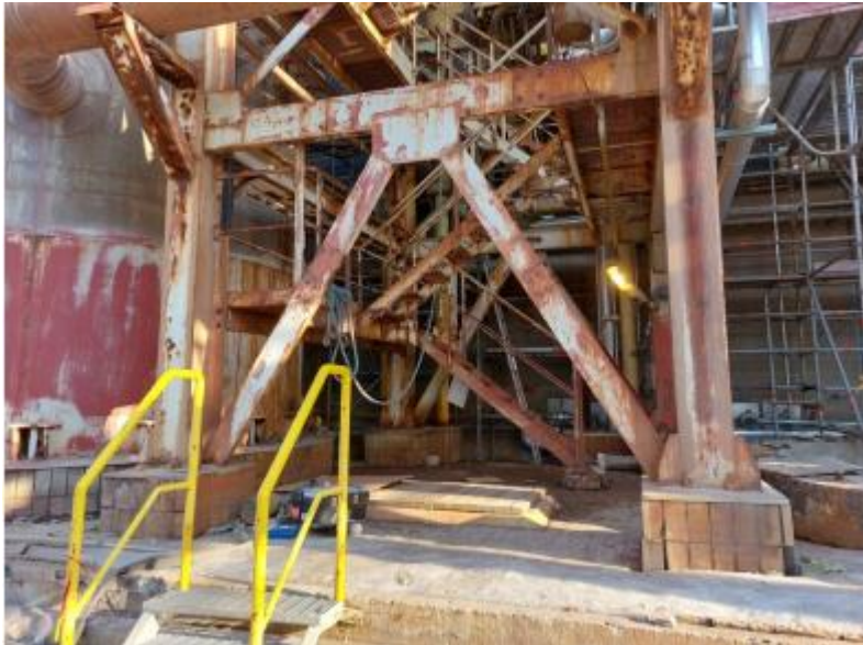
Kuva 5. Yleinen korroosio teräsrakenteessa
