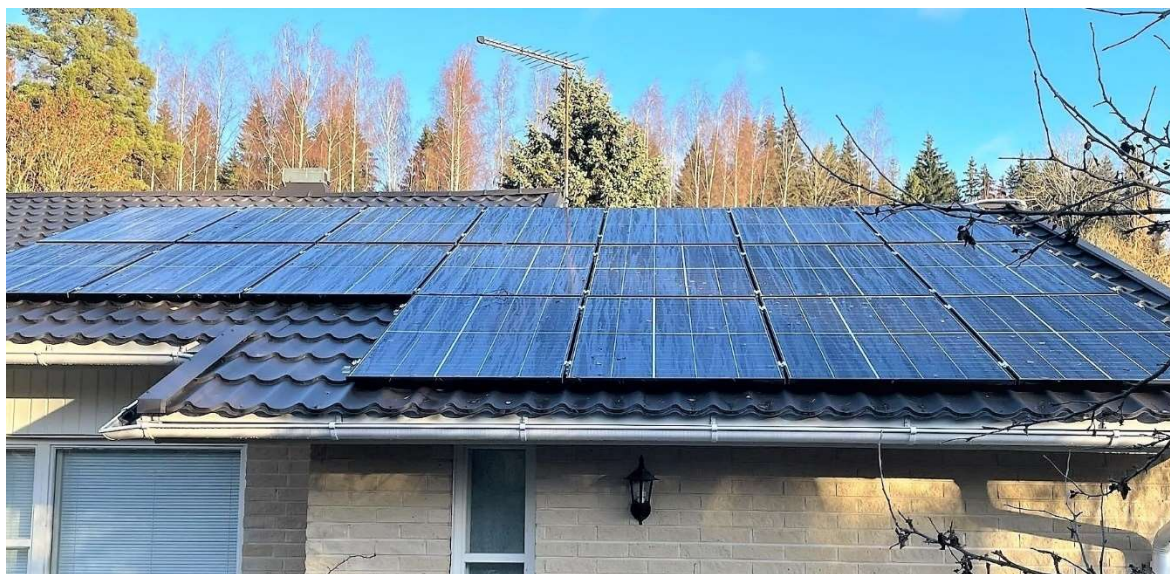
Kuva 10. Omakotitalon katolle asennettu 7,2 kWp aurinkosähköjärjestelmä
