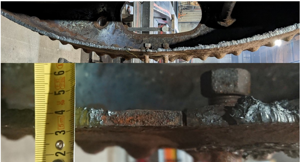
Kuva 11. Vaipan paksuus kattilan pohjalla. Kuva on otettu kattilan etuosasta, kattilan pohjaan leikatun aukon laidalta. Vaippa on pohjalta huomattavasti ohuempi kuin muualta.
