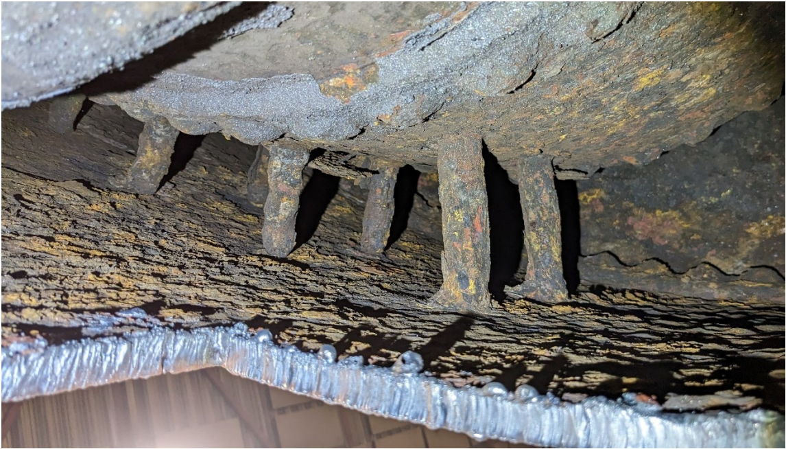
Kuva 14. Sidepulttien korroosiota kattilan takaosasta, vinotuen lähetyviltä
