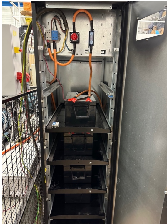
Kuva 4. Jopin neljä suljettua AGM-akkua testikytkennässä laboratoriossa
