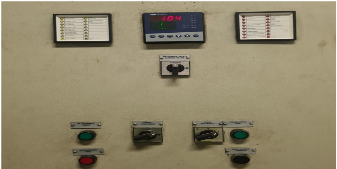
Kuva 56. Kattilan paikallis- ohjaus.
