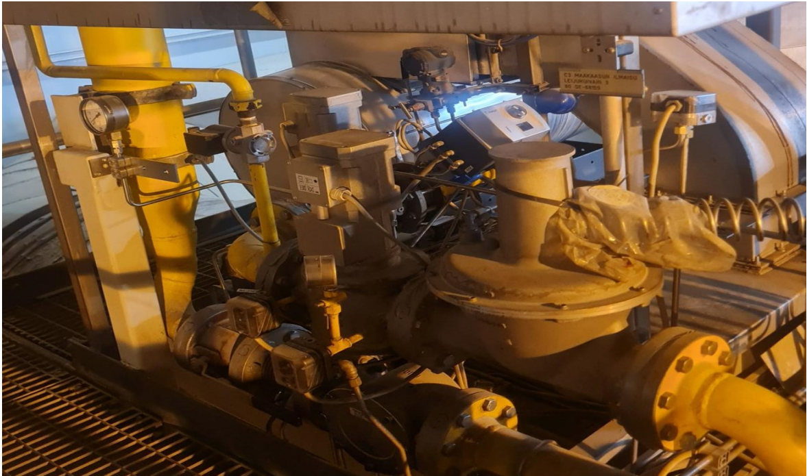
Kuva 44. Maakaasun syöttö polttimelle.
