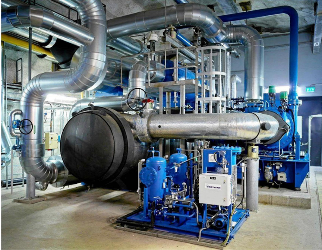
Kuva 6. Lämpöpumppulaitos, Helen Katri Vala (Helen 2020)
