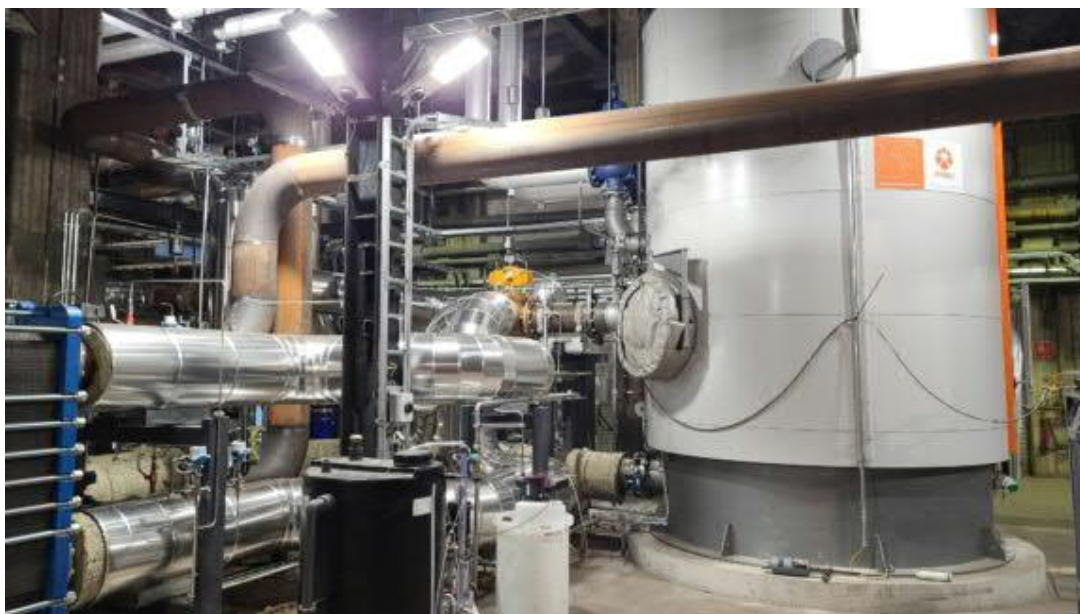
Kuva 12. PARAT Halvorsen AS:n sähkökattila Vaskiluodossa (EPV Energia Oy 2021a).
