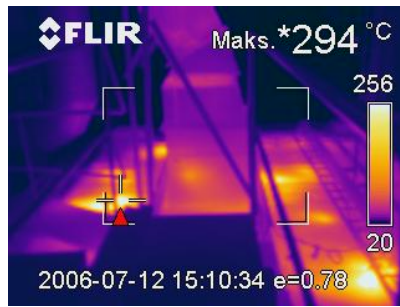
Kuva 63: Huippulämpötila lk-uunin katolla
