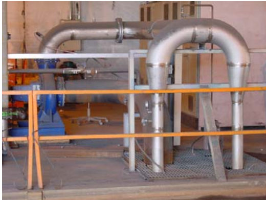
Kuva 61: Puhdistamo 2 karkaisualtaan kierrätysvesipumppu
