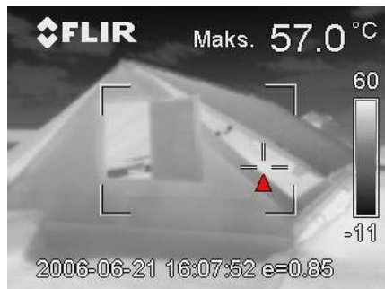
Kuva 48: Sulaton kattoluukun lämpösäteilyä
