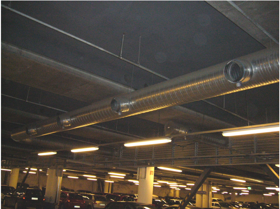
Kuva 1. Ilmanvaihtokanavia Kampin pysäköintihalli
