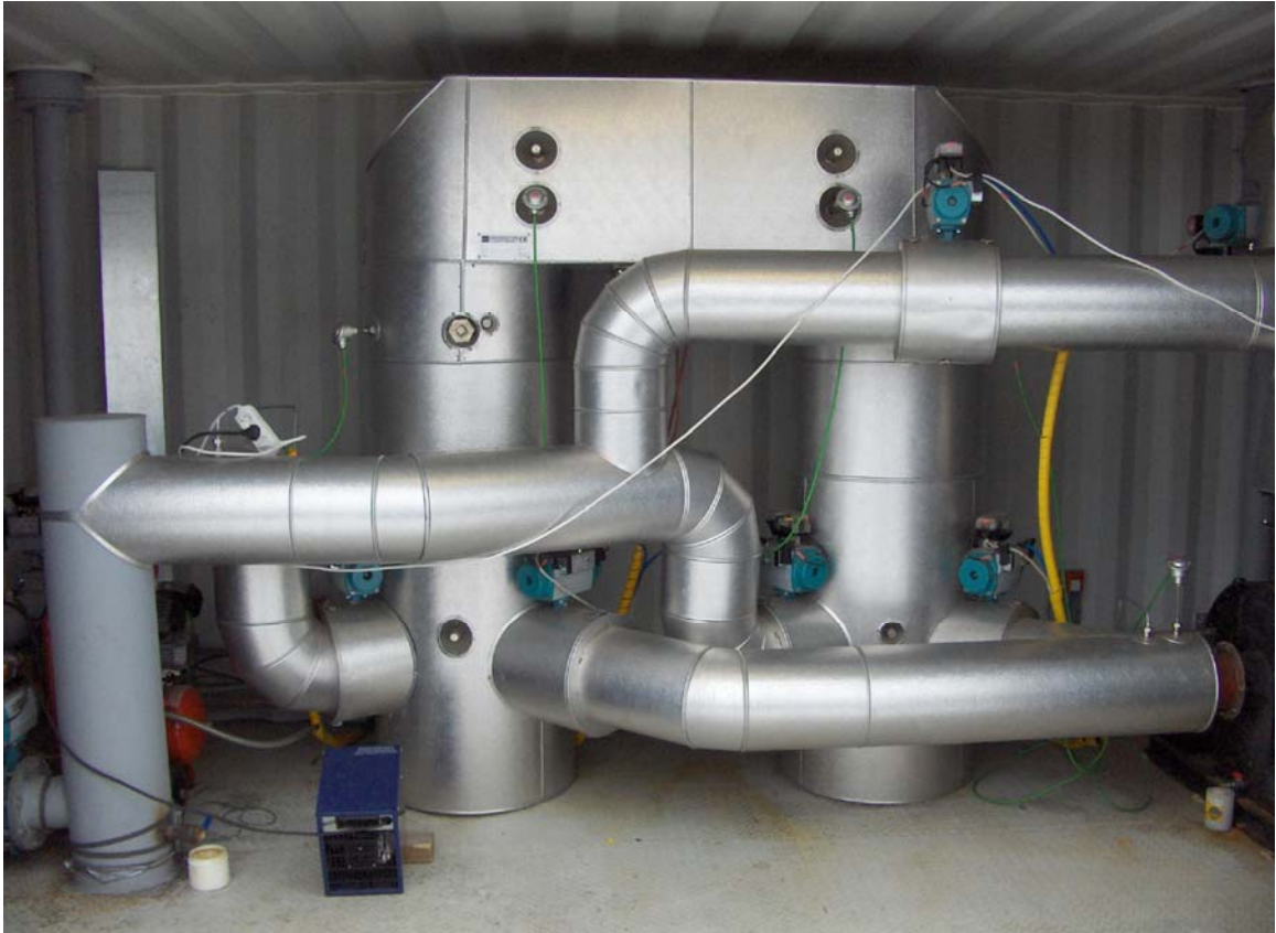
Kuva 26. Ammoniakin käsittelyyn modifioitu VOC-polttolaitos
