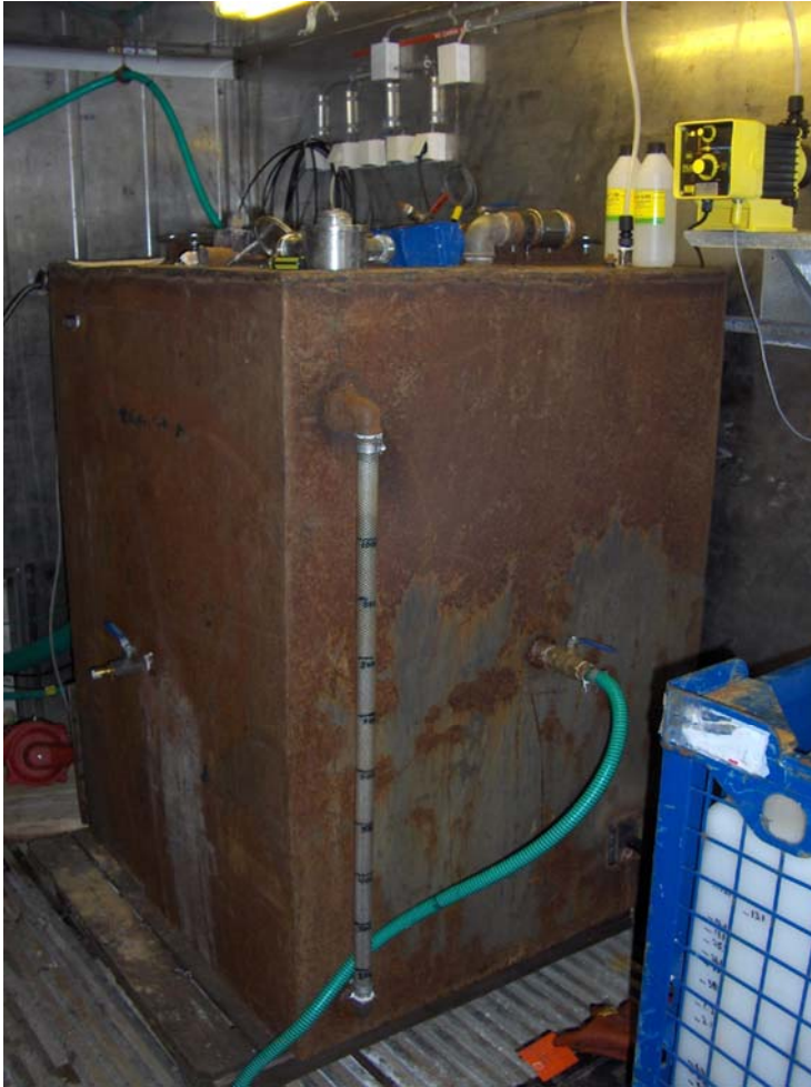
Kuva 22. Sekoitussäiliö ja pH:n säätölaitteisto.
