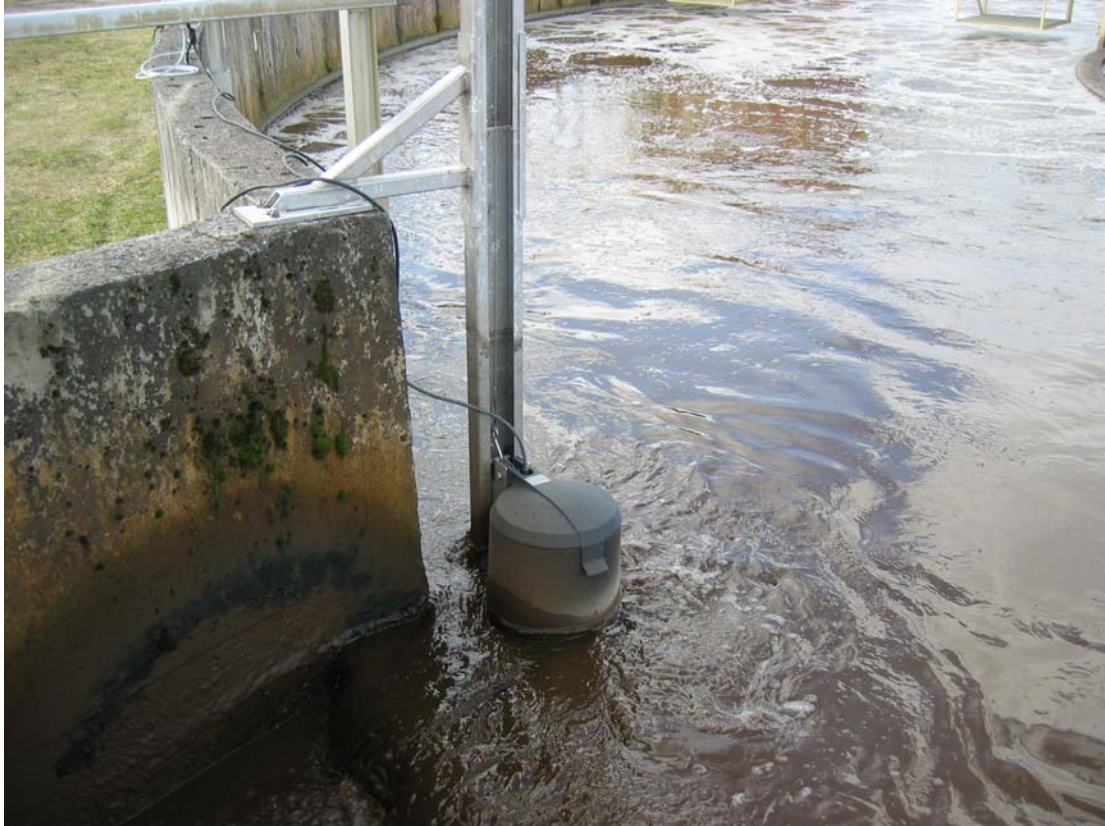
Kuva 13. Evita Insitu 4100-ammoniumtyypianalysointilaitteisto kenkäveronniemen ilmastusaltaassa
