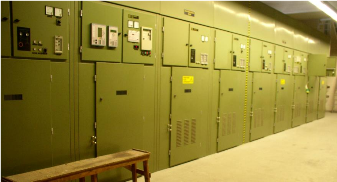
Kuva 2.2. 10,5 kV pääkeskukset 12S104 ja 12S105.
