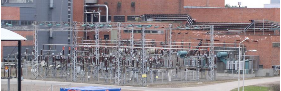
Kuva 2.1. 110 kV ulkokenttä 12S101.
