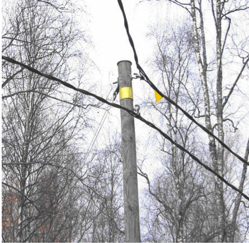
Kuva 5.1. 1 kV pylvään merkintä (YJ 7:06).
