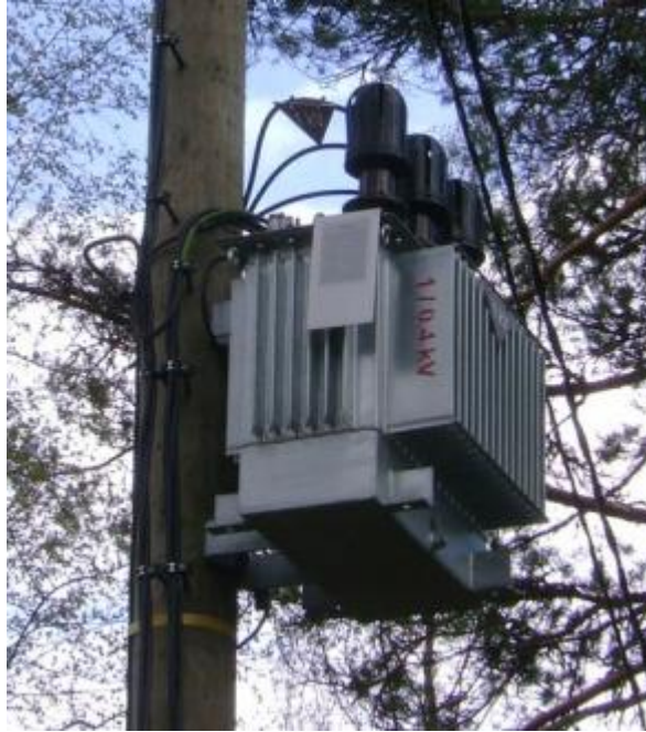
Kuva 2.5. 1/0,4 kV muuntaja (SSS 2009).
