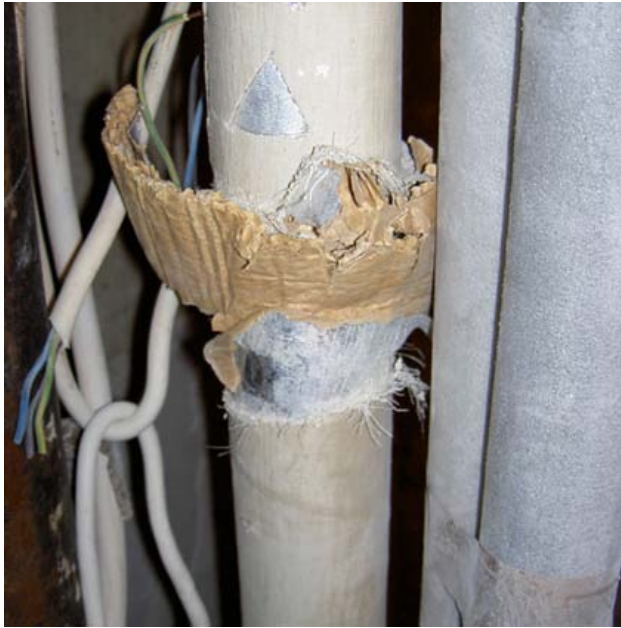
KUVA 7. Putkieristeen asbestipitoinen pintakangas. (Ylö-Asbest Oy 2009)
