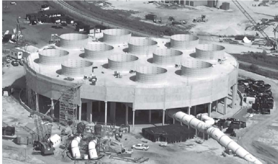
Kuva 13 Ympyränmuotoon rakennettu poikkivirtaustorni. (Hensley 2009)
