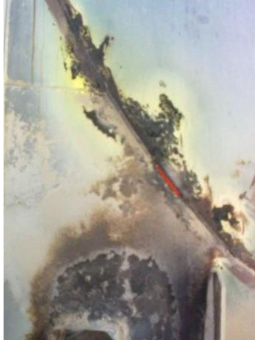
Kuva 5.2. Kalsinaattorissa oleva Hot Spot -alue, joka on jo vaurioittanut teräskuorta.
