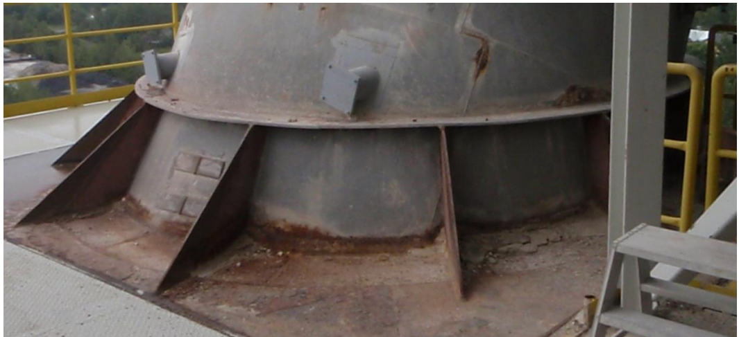
Kuva 6.2 Laskuputki on kiinnitetty hitsaamalla teräsrakenteisiin alkuperäisen suunnitelman vastaisesti.
