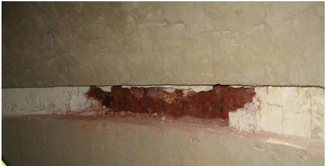
Kuva 5.22. Kalsinaattorin sisäpuolelta otettu kuva, jossa näkyy teräskuoren korroosiovaurioinen pinta tiilien ja eristeen poiston jälkeen.
