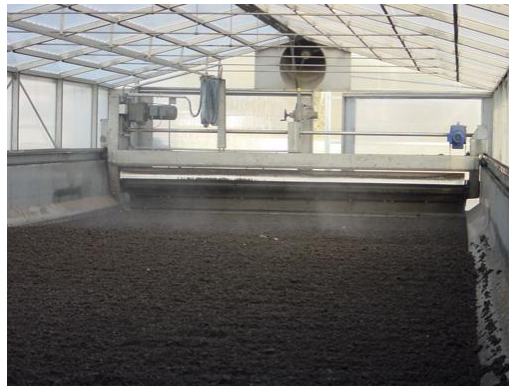
Kuva 46. Lietteen aurinkokuivaus kasvihuoneessa (Hydropress Huber AB b)
