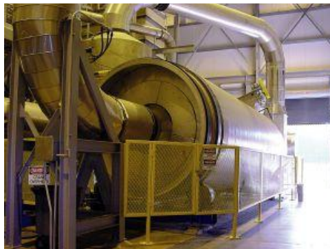
Kuva 26. Rumpukuivain (Andritz b)
