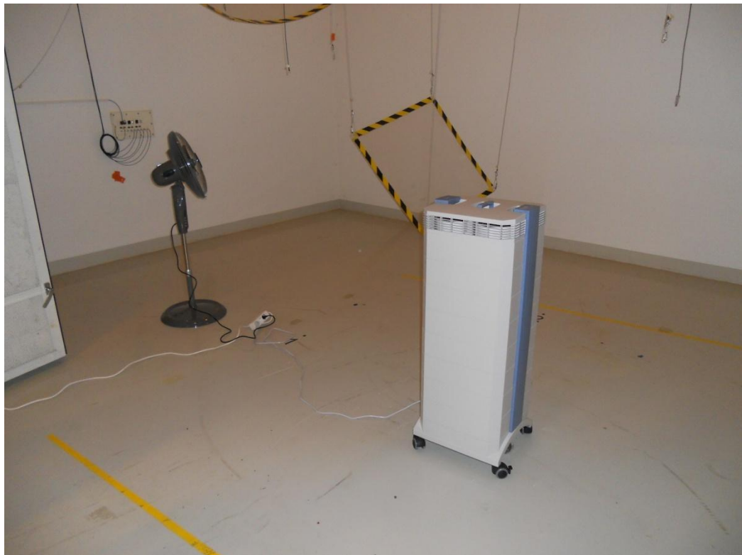
Kuva 11. IQAir GCX-VOC-ilmanpuhdistin koehuoneessa.
