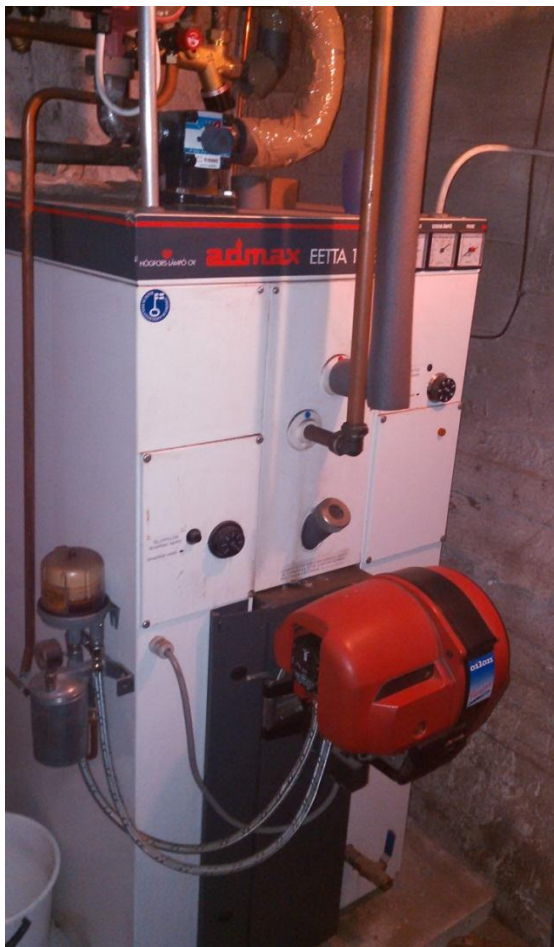
Kuva 5. Öljykattila ja -poltin
