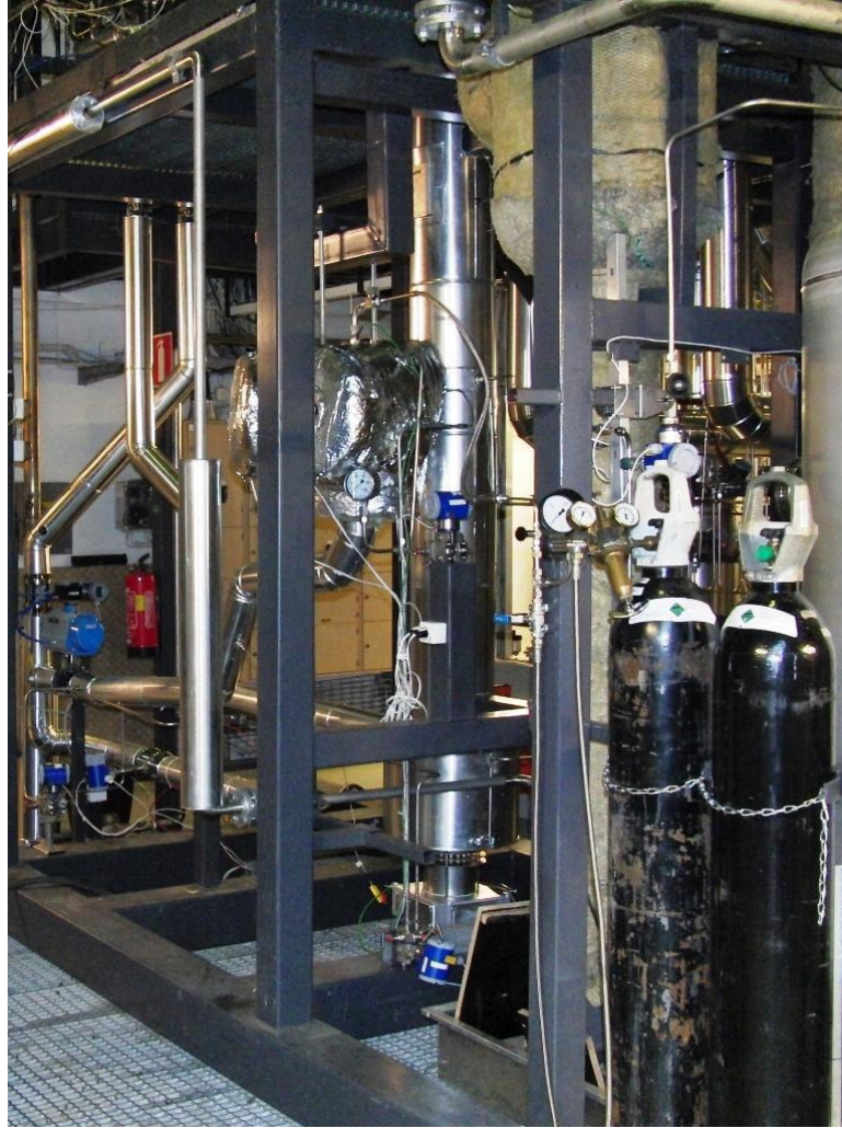
Kuva 5. Korkeapainekoelaitte (Laine 2013, liite 3, 1).
