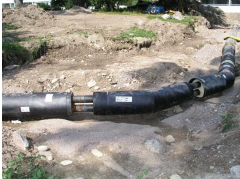
Kuva 5: Kaukolämpöverkon runkolinja (Energiateollisuus 2014a).
