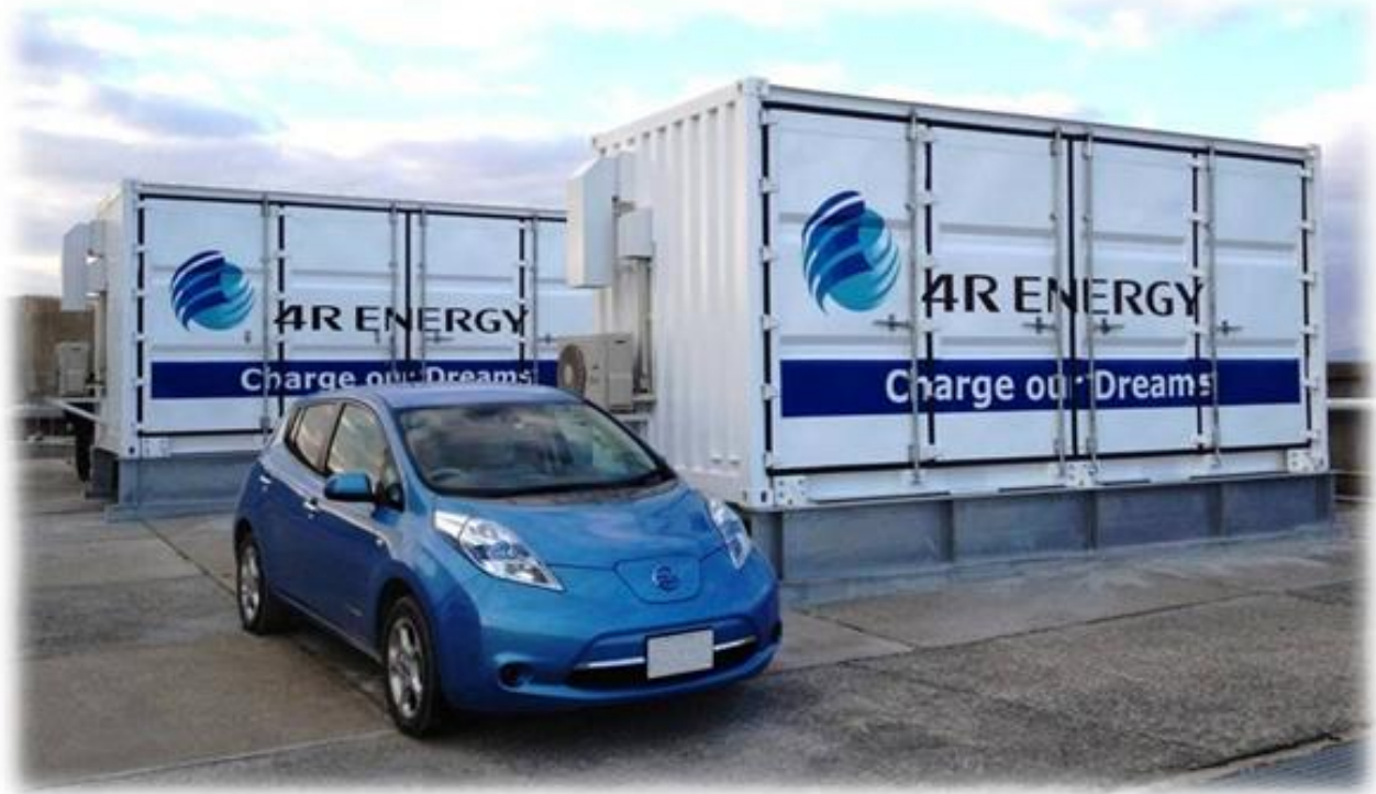
Kuva 3.5. 4R Energy Corporationin kehittämä aurinkovoimalan tuotannon tasoittamiseen tarkoitettu prototyyppi ja Nissan Leaf, jonka akkuja järjestelmässä käytetään. (Kuvallähde: Sumitomo Corporation 2014)
