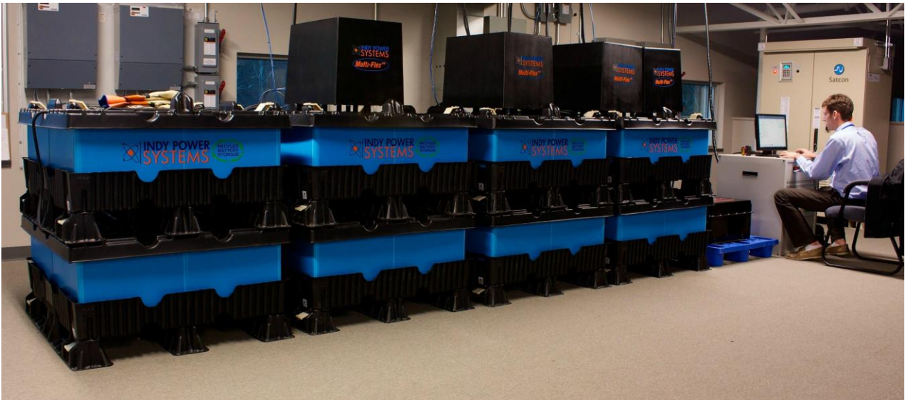
Kuva 3.6. Indy Power Systemsin sähköverkon kulutushuippuja tasoittava järjestelmä. (Kuvälähde: Tolen 2012)
