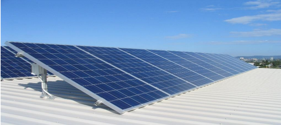
Kuva 4. Monikideaurinkopaneelien muodostama paneeliketju hallin katolla. (Liberty Voice, 2014)
