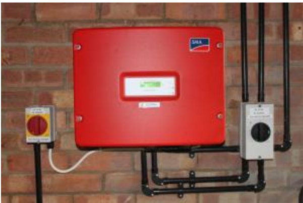
Kuva 5. Vaihtosuuntaaja sekä erotuslaitteet. (Sustain UK, 2016)
