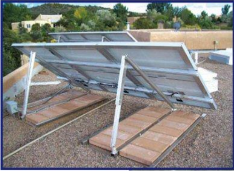
Kuva 10. Asennustelineen jättämä taskumainen tila (Wired Pakistan 2016).
