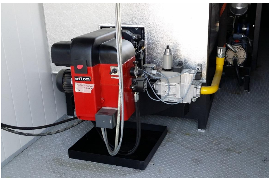
Kuva 6. Kaasupoltin Kivikylän Kotipalvaamon lämpökontissa.
