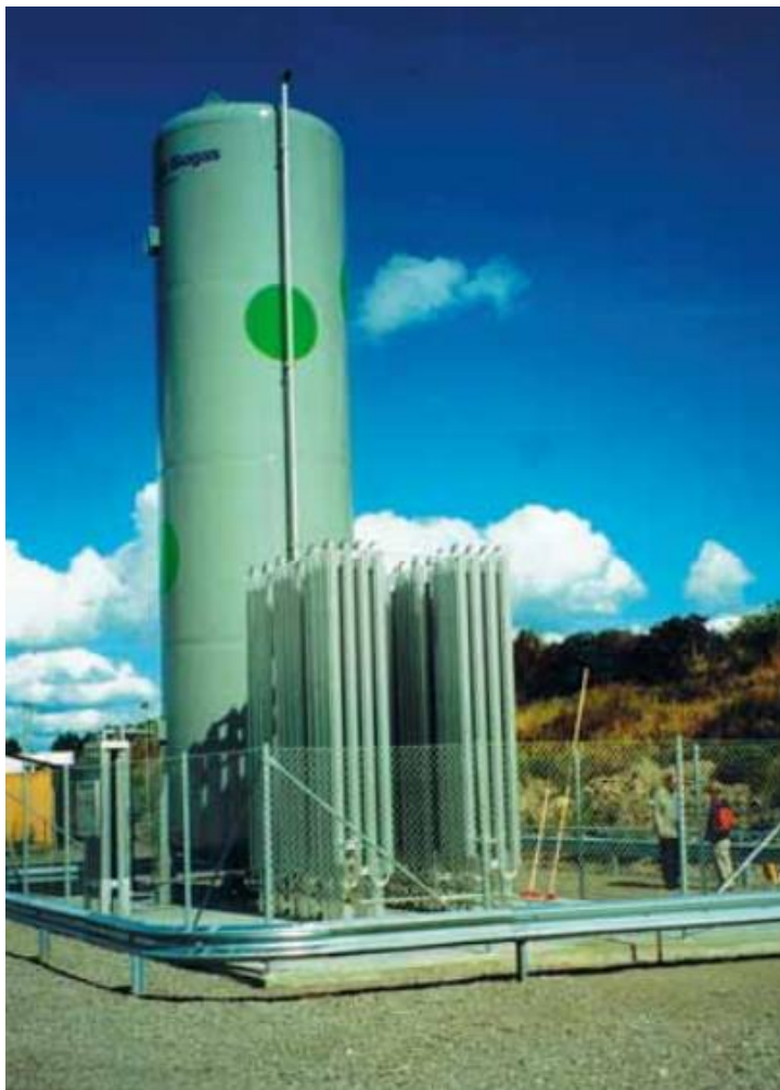
Kuva 3. Linköpingissä sijaitseva 53 m 3 :n LNG-varasto, jolla varmistetaan kaasun saatavuus biometaanin liikennetankkausasemalla. (Maakaasuyhdistys 2009, 16)
