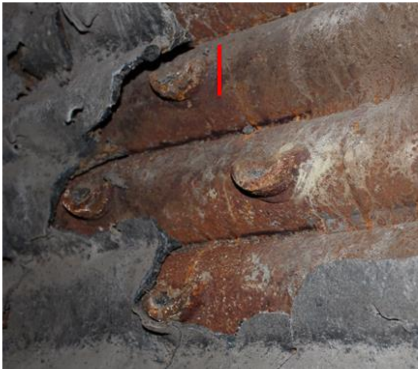
Kuva 15. Jäähdytyspaneeliin hitsatut kuonatartunnat. Kuvassa punainen viiva esittää vauriokohdan hitsin rajaviivalla.
