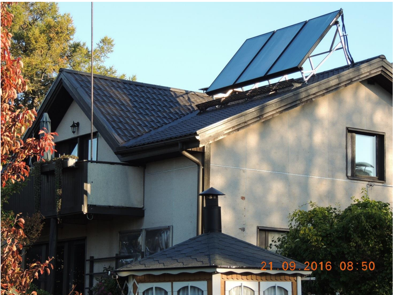
Kuva 4.1 Aurinkolämpökeräimien sijainti katolla.
