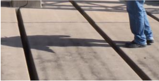
Kuva 10. Aukko ontelolaatta-arinan elementtien välissä.
