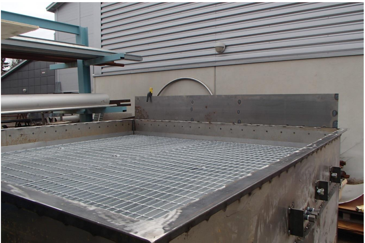
Kuva 3. Testilaitteeseen lisätty suojalevy.
