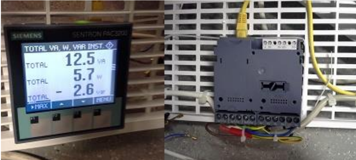
Kuva 2.3 Siemens Sentron PAC3200-verkkoanalysointilaitteeseen kytkettyä älypakastimen ohjauslaatikkoon energian- ja tehonkulutuksen seurantaan varten.
